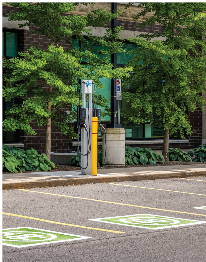
Bornes de recharge pour VE installées en 2023 2611 Queensview Drive, Ottawa, ON
